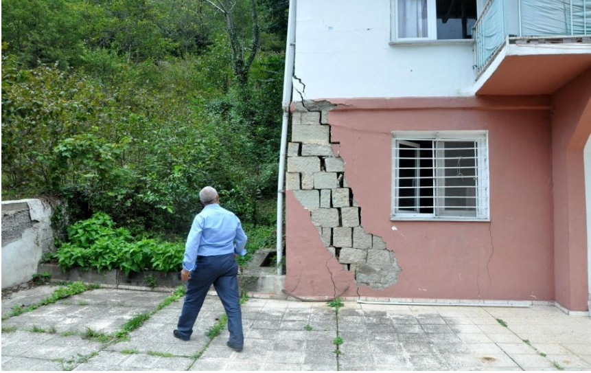
Şekil 19: Atasu Barajı yakın yerleşimlerde baraj inşaatı sırasında oluşan çatlaklar
