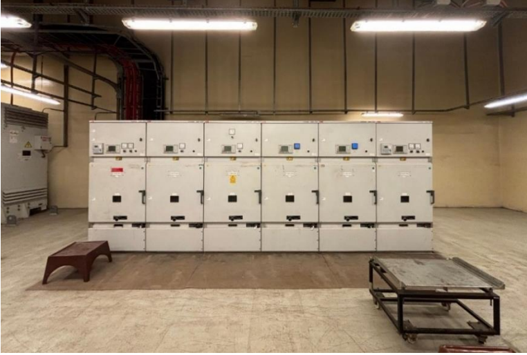
Şekil 10 - M4 Metrosuna ait OG hücreleri
