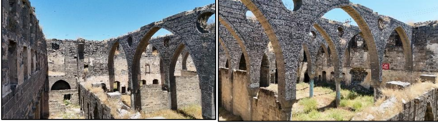
Şekil 17 Yapı iç cephelerinde sıva ve boya hasarları
