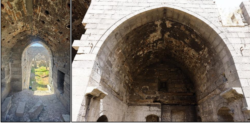
Şekil 13 İç mekân da nem ve sıva dökülmeleri
