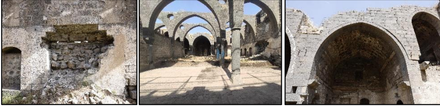
Şekil 15 Duvar ve döşemede malzeme kayıpları
