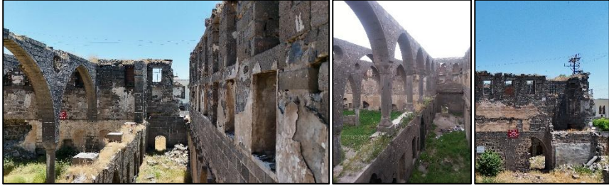
Şekil 11 Deprem etkisi ile koro katında ve cephede yıkılan bölümler
