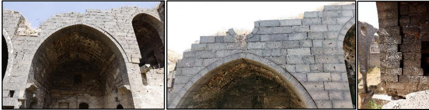
Şekil 10 Apsis cephesi strüktürel çatlak ve ayrışma hasarları
