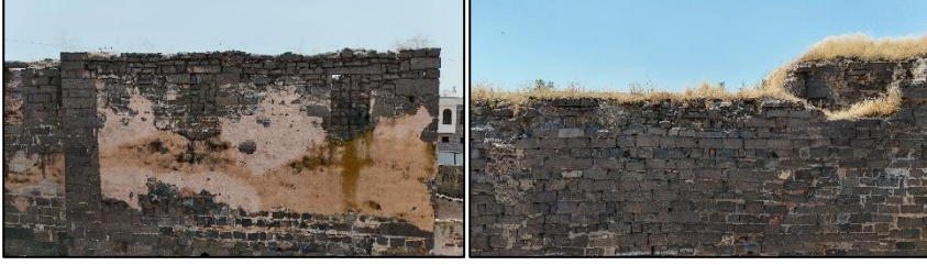
Şekil 19 Özgün dokusunu kaybeden cephe duvarları
