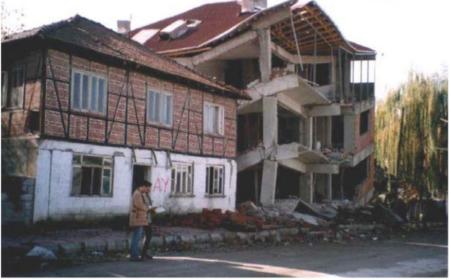
Şekil 12. 1999 Kocaeli/Gölcük depreminde etkilenen ahşap ve beton evlere örnek (Doğangün, Livaloğlu, Tuluk ve Acar, 2005).
