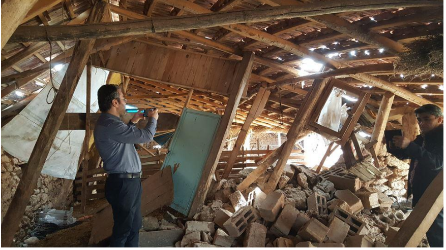
Şekil 13. 1999 Kocaeli/Gölcük depreminde etkilenen ahşap eve örnek (İnsaatim, 2024).
