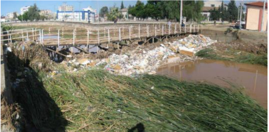
Resim 3 Dere yatağına çöp, moloz, sanayi ve evsel atık atılması
