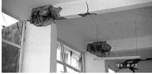
Resim 6 Düğüm Noktasında Mafsallaşma ve Kirişte Eğilme Hasarı
