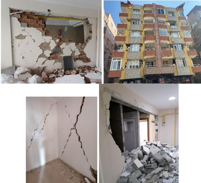
Resim 1 Dolgu Duvar Hasarları
