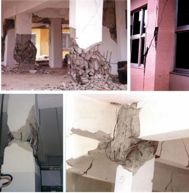
Resim 5 Kolonda Burulma Hasarları
