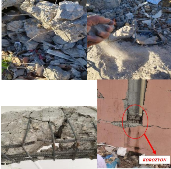
Resim 12 Beton Kalitesi ve Korozyon Hasarları
