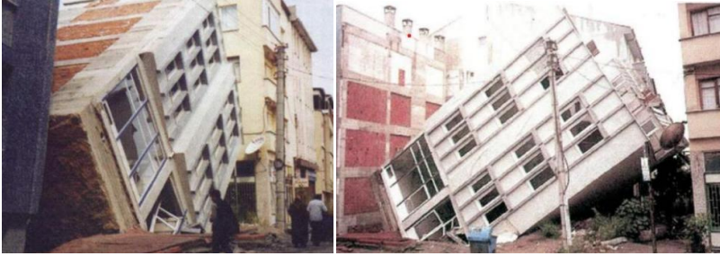
Resim 13 Zemin Sıvılaşma Hasarları
