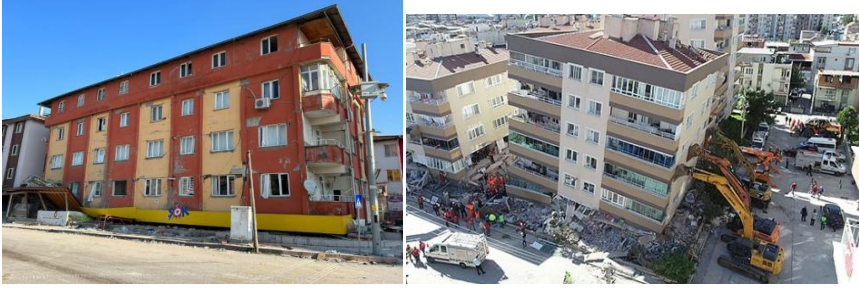
Resim 9 Yumuşak Kat Hasarları
