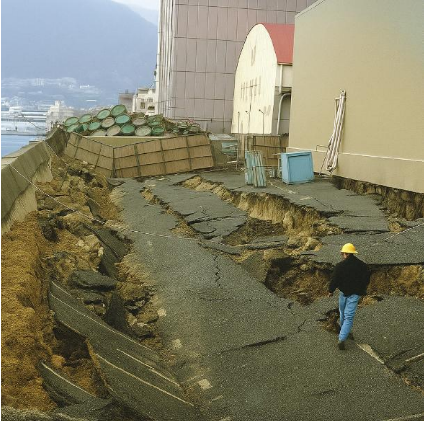
Şekil 14 1995 Kobe depreminde sıvılaşma nedeniyle istinat yapısının göçmesi
