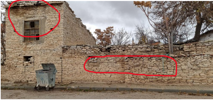
Şekil 11. Yağmur, kar sonucu taş malzemede oluşan biyolojik bozulmalar
