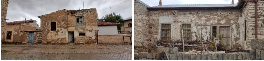
Şekil 6. Alandaki bakımsızlık sonucu oluşan sıva dökülmeleri, taş ve ahşap malzemede çürüme ve malzeme kaybı
