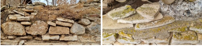
Şekil 12. a) taş malzemede görülen bitki oluşumları b) taş malzemede yosun oluşumu
