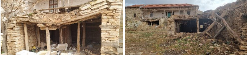
Şekil 10. Yağmur, kar yüküyle toprak damın çökmesi sonucu yapıların tahrip olması
