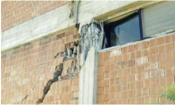
a) Kısa kolon hasarı
