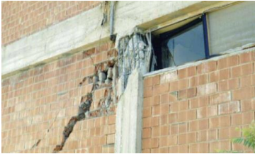
a) Kısa kolon hasarı
