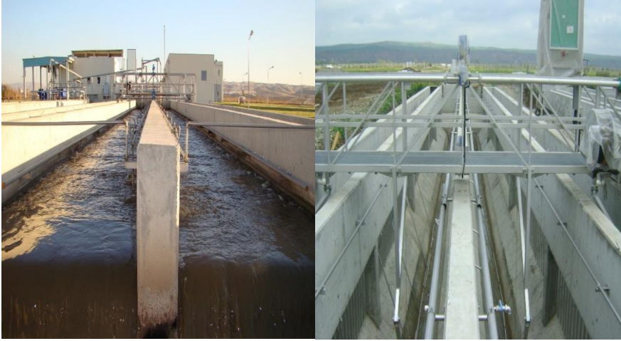
Şekil 6. Kum ve Yağ Tutucu Ünitesi
