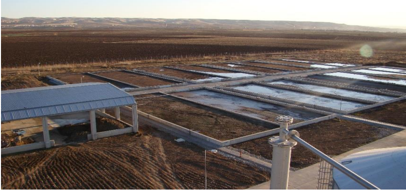
Şekil 12. Çürütülmüş Çamur Kurutma Yatakları
