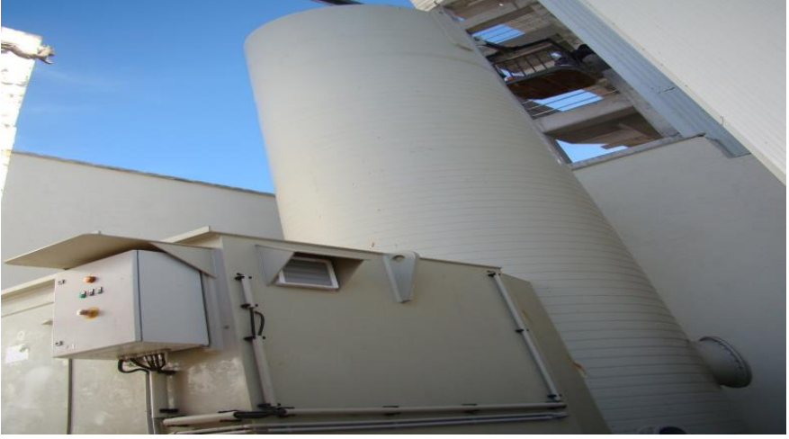
Şekil 10. Gaz Kükürtsüzleştirme Ünitesi
