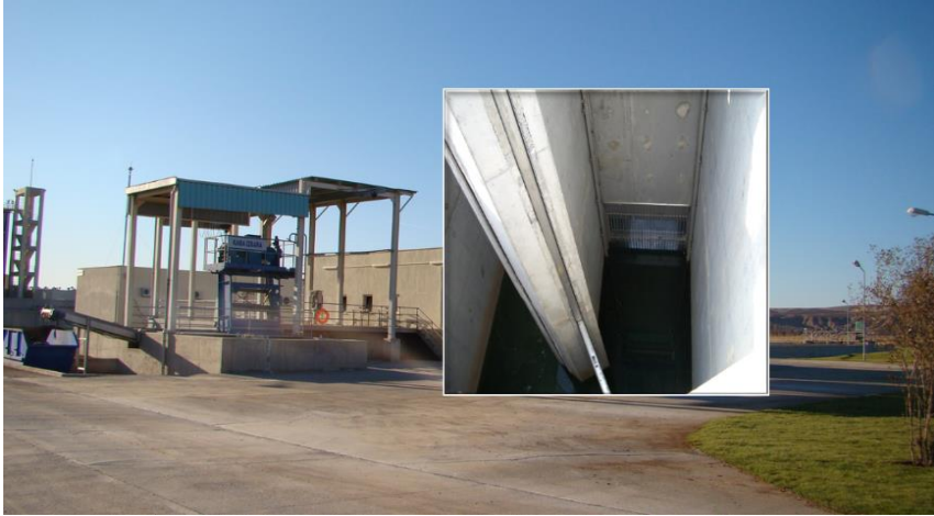
Şekil 4. Kaba Izgara Ünitesi
