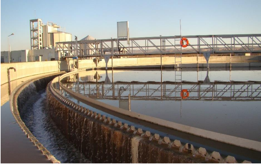
Şekil 7. Ön Çöeltme Havuzu
