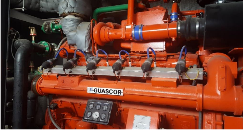
Şekil 13. GUASCOR FGLD 360 tipinde biyogaz yakıtlı gaz motoru
