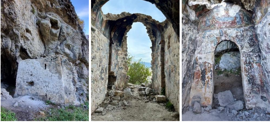
Şekil 35. Manastırın şapelinin güney cephesi (solda) üst örtüsü ve apsindeki yıkılmaların görüldüğü iç mekanı (ortada) ile tahribatlarla günümüze ulaşan fresklerinden (sağda) görünümüler (Çolak Muşmul & Engin, 2024).
