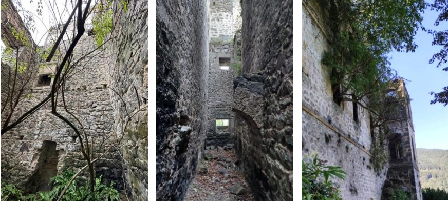
Şekil 27. Manastırın çatı ve ara kat döşemeleri günümüze ulaşmayan Keşiş Hücreleri ve Yemekhane binasının oda (solda) ve iç koridorları (ortada) ile taş bozulmalarının olduğu doğu cephesinden (sağda) görünümüler (Çolak Muşmul & Engin, 2024)
