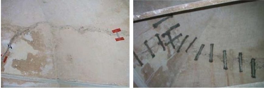
Şekil 7. Pertevniyal Valide Sultan Camisinin kubbesindeki çatlakların ölçümü ve paslanmaz metal kenetlerle sağlamlaştırılması çalışmalarından görünümüler (Çebi, 2010).
