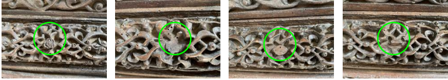
Resim 19 Eser yüzeyinde vandalizm örneği.
